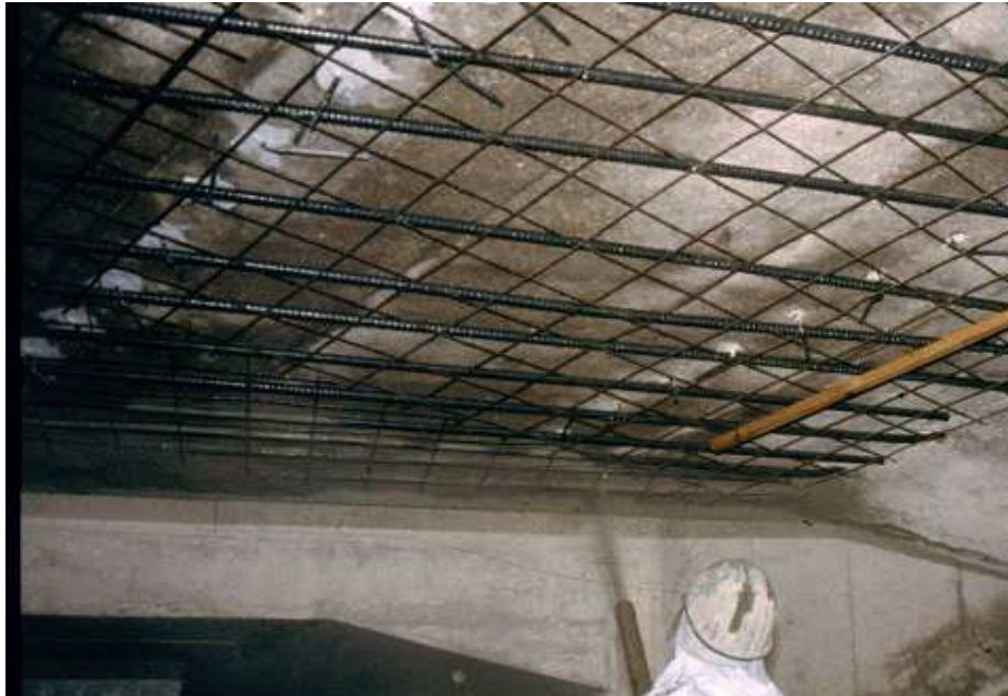
Détail début de projection sur l'angle de coffrage (PI autoroute A6 à JOIGNY)
