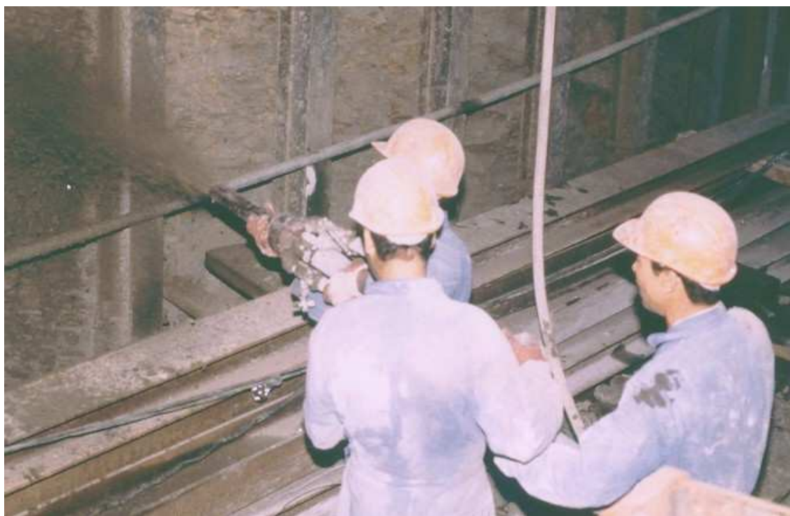
Utilisation d'une lance de projection par voie mouillée flux dense en tunnel
