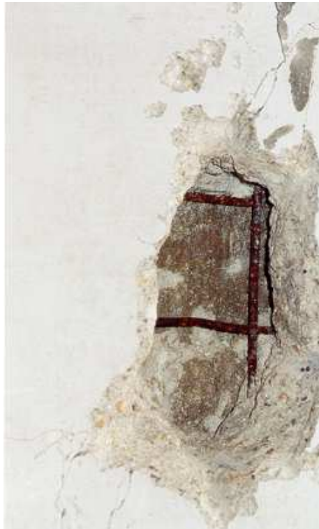
Vue détaillée d'une nappe de treillis plaquée à la paroi et recouverte de 8 cm de béton projeté. Dans ce cas, le treillis ne peut jouer aucun rôle contre la fissuration de surface.
