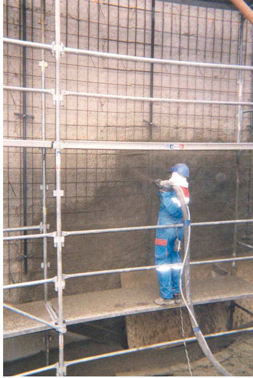
Echafaudage conforme à la législation mais inadapté pour la qualité de la projection (distance lance-paroi trop courte par manque de recul)
