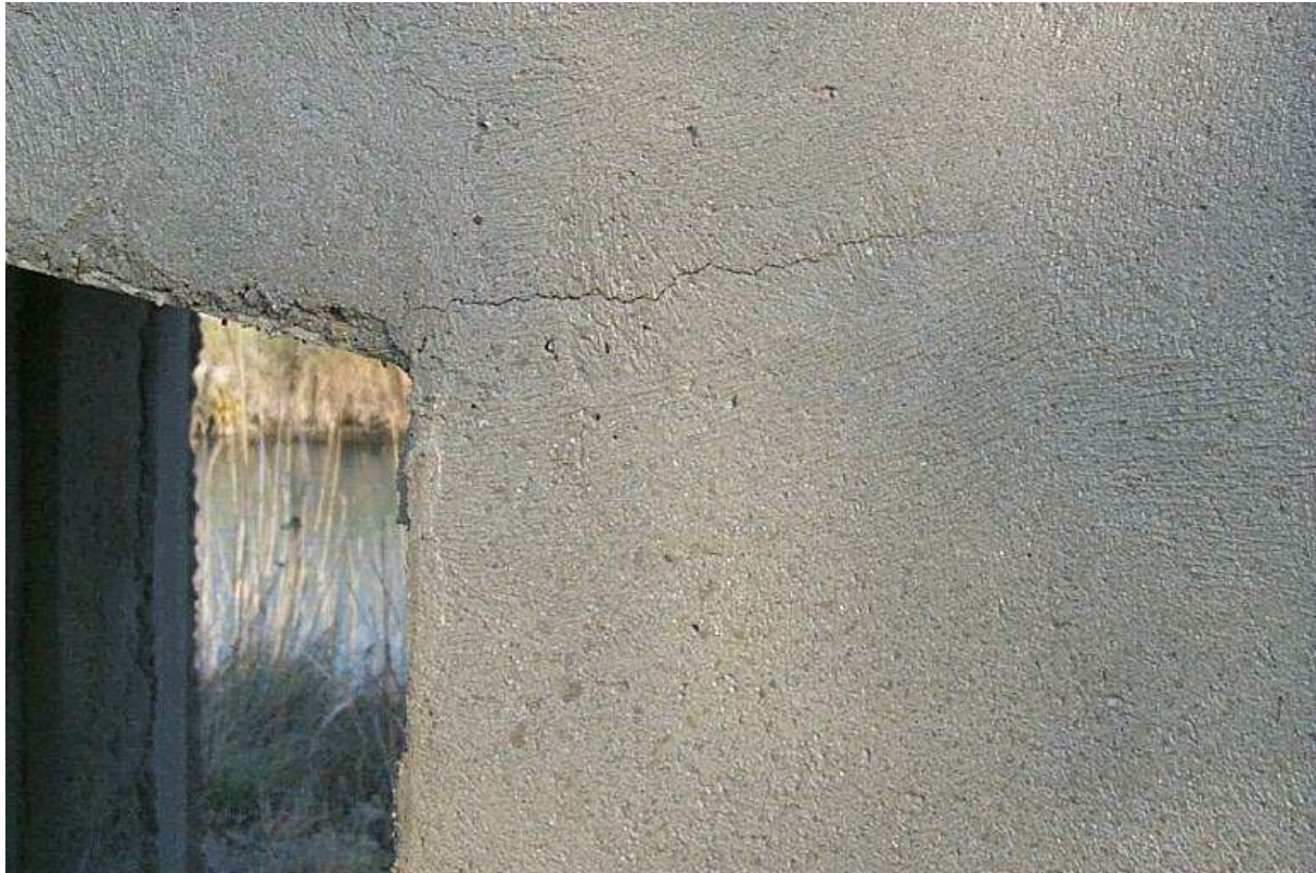
Fissure de retrait de la couche de finition due à un excès d'eau
