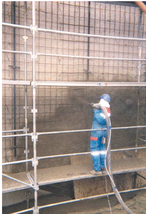
Projection de béton par voie sèche pour renforcement de voile suite à une géométrie défectueuse du béton après décoffrage. (Attention : la largeur de l'échafaudage est ici insuffisante)
