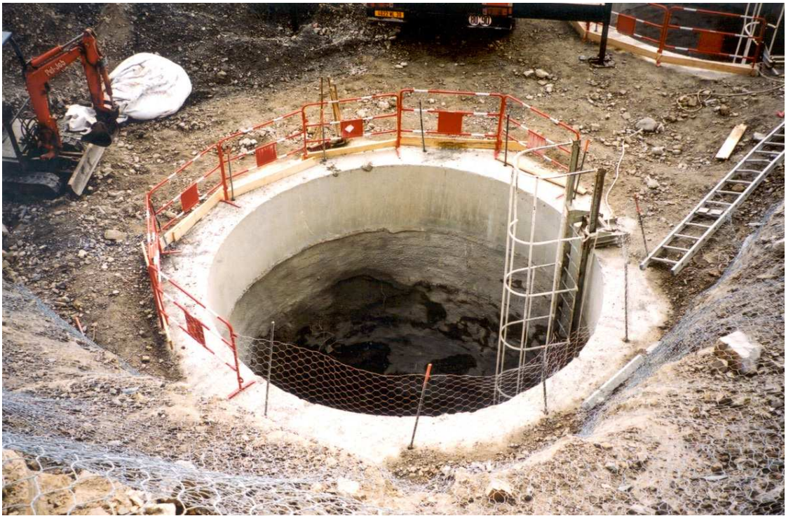
Puits marocain d'une pile du viaduc de Millau Projection par voie sèche sous un premier anneau coffré
