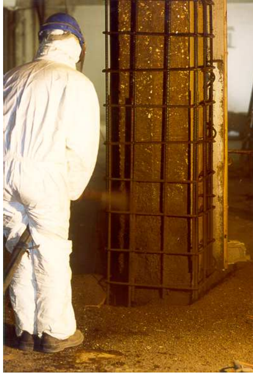
Immeuble d'habitation à Annemasse : Ajout d'armatures Début de la projection par voie sèche
