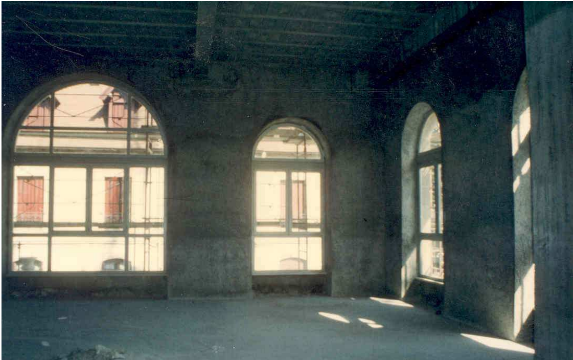
Théâtre de Lons Le Saulnier après incendie. Ces maçonneries, classées monuments historique, ont été chemisées par du béton projeté
