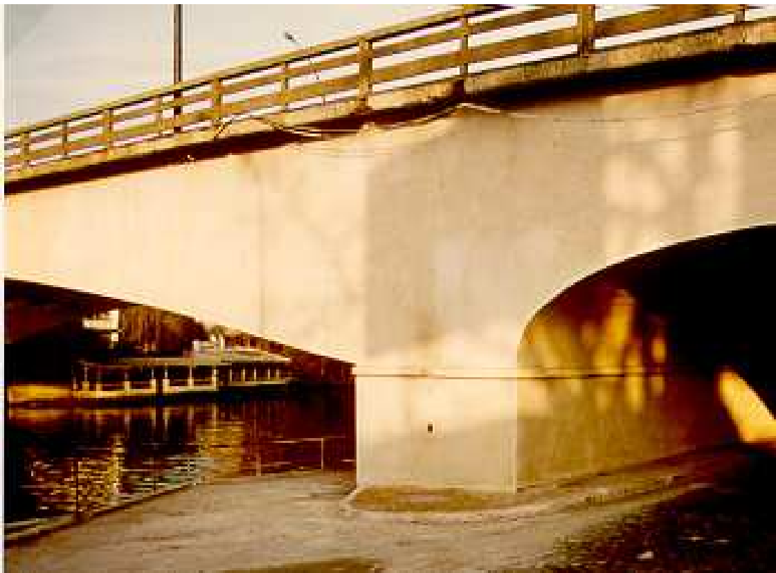
Pont de Bry-sur-Marne après réparation par béton projeté voie sèche ( finition ciment blanc)
