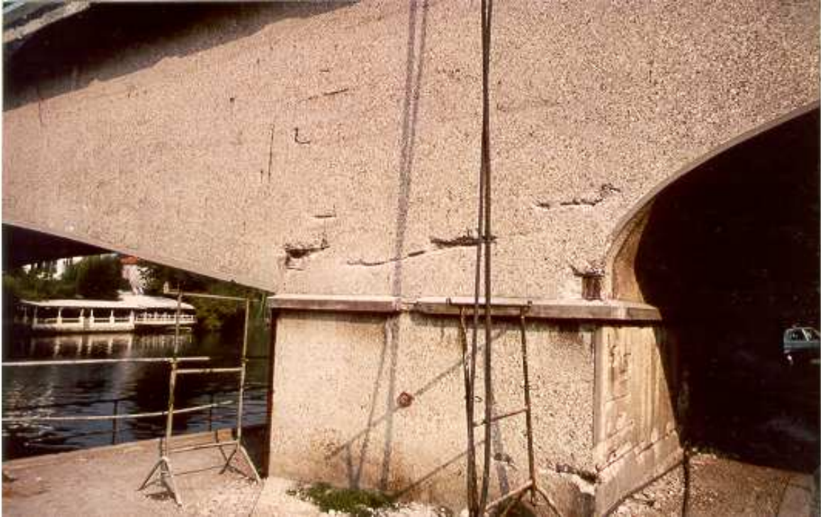
Pont de Bry-sur-Marne : éclatement du béton d'enrobage
