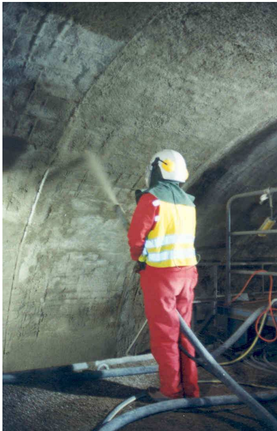
Réparation du tunnel sous la Manche après l'incendie de novembre 1996 : projection par voie sèche d'un béton fibré
