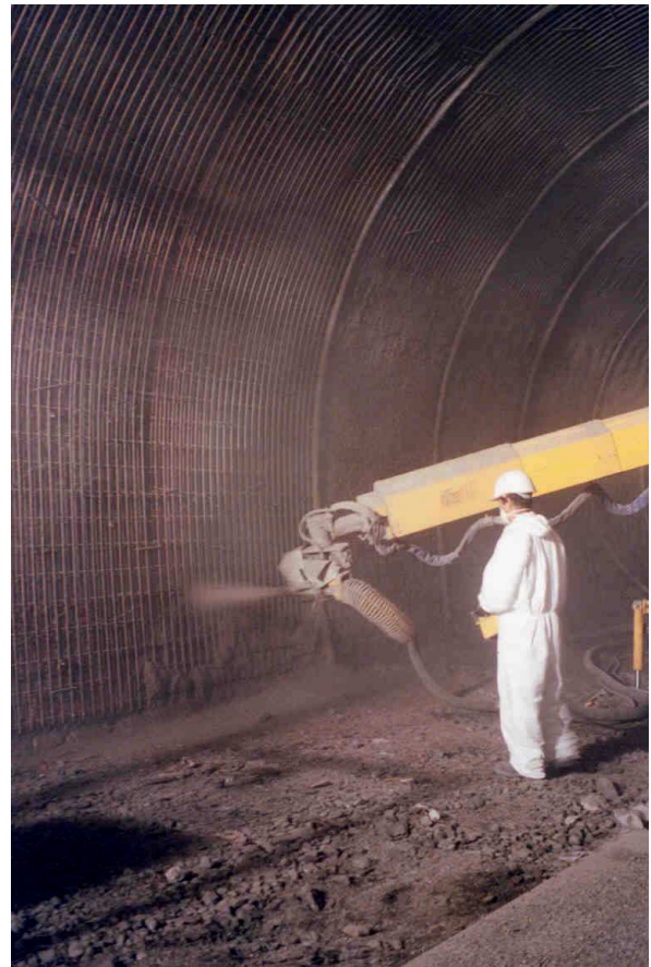
Renforcement du tunnel de l'AVE MARIA (Port de Boulogne) : projection robotisée par voie sèche d'un mélange non fibré
