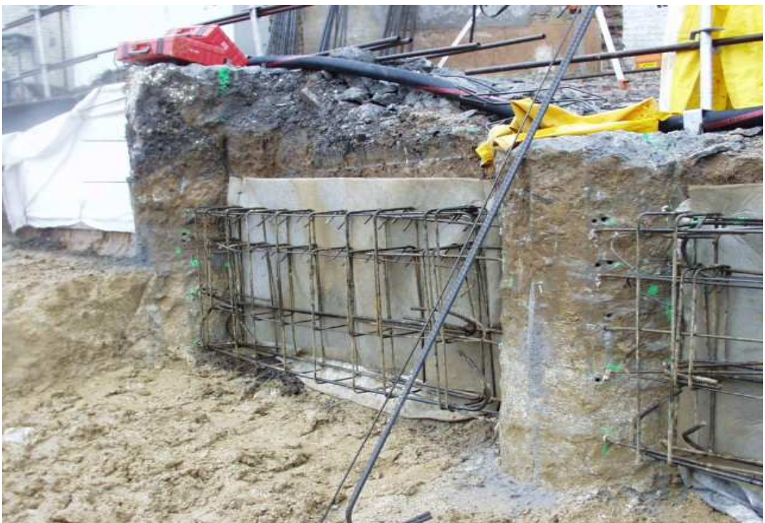
Paroi berlinoise avant projection par voie sèche d'un béton non fibré (les 40 cm d'épaisseur sont mis en place en une seule couche)
