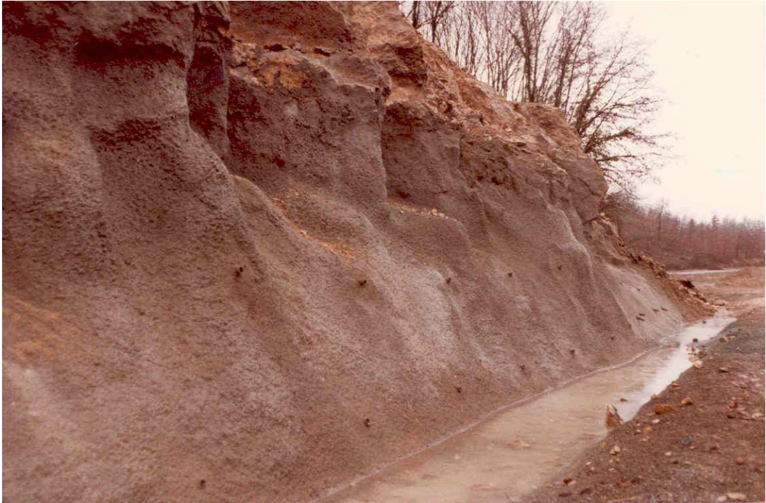
Protection de talus : boulonnage et projection par voie sèche d'un mélange non fibré
